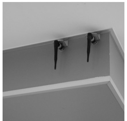
写真3 東京駅構内に設置された無線LANのアンテナ
